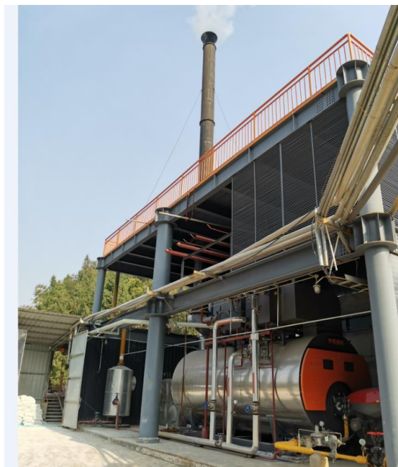
图3-5 锅炉房及排气筒（15m）
